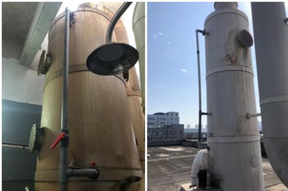
图 4-4 喷淋吸收塔实际现场图
