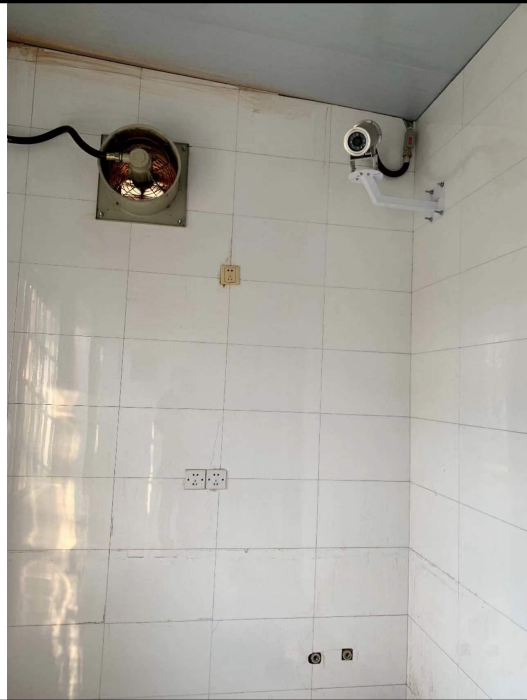
危废仓库内部视频监控及通风扇
