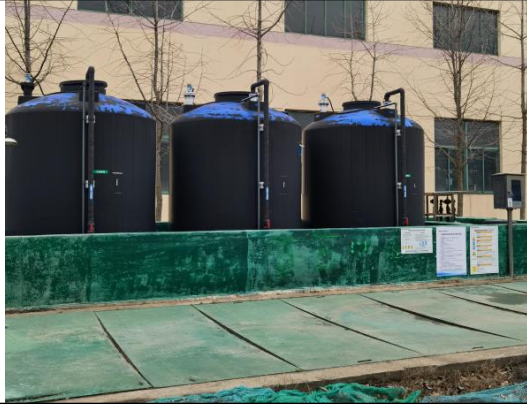
次氯酸钠储罐
