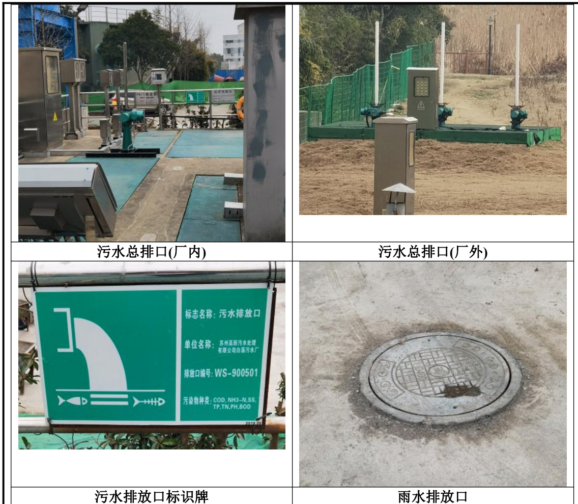
图 3-2 雨、污水排口及环保标识牌
