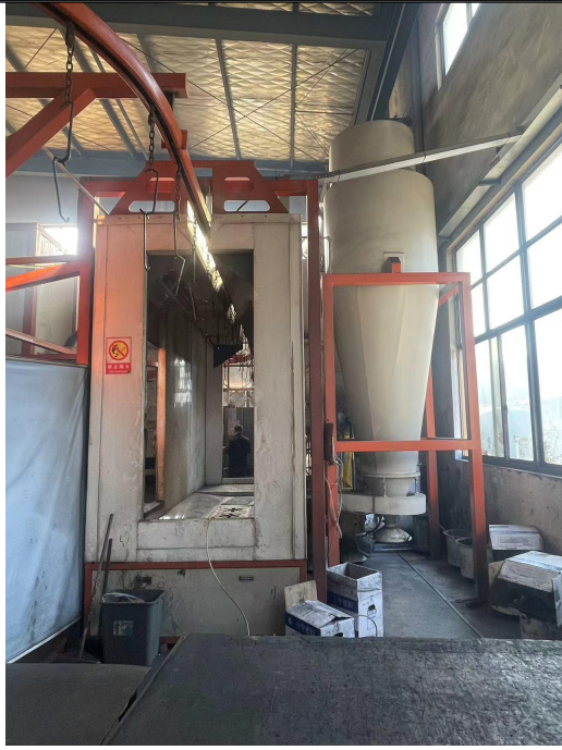
喷粉粉尘旋风除尘装置
