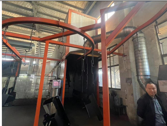
固化废气集气装置
