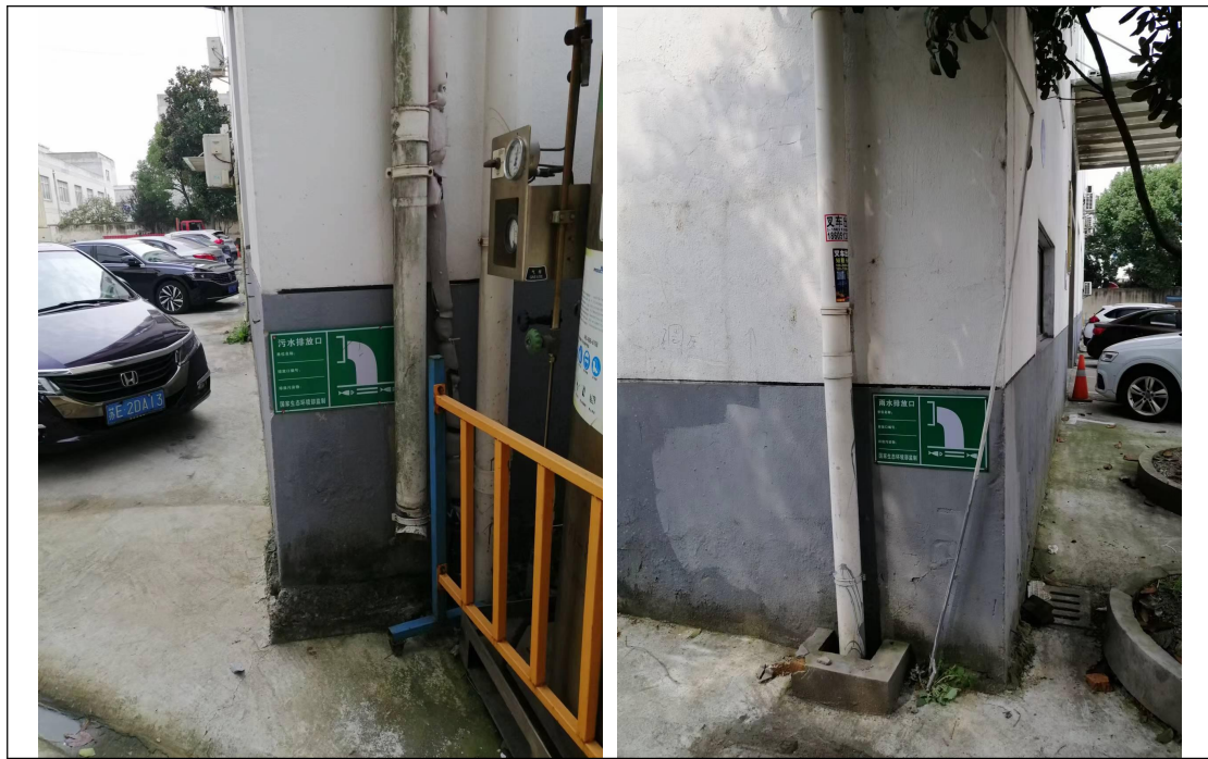
图3-1 污水排口标识牌
