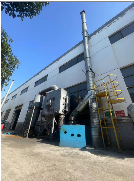
抛丸粉尘旋风+脉冲滤筒除尘装置
