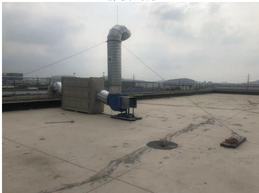
废气处理设施
