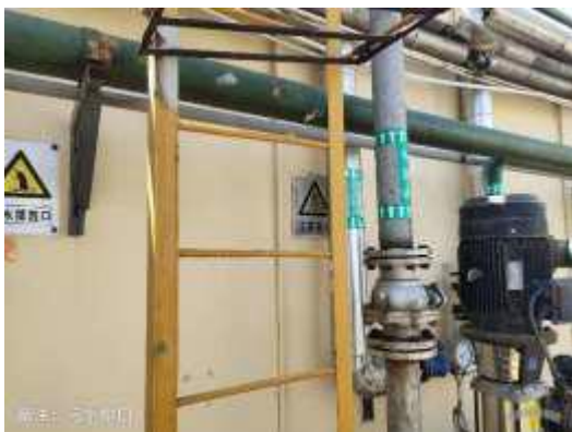
污水排放口强排水泵
