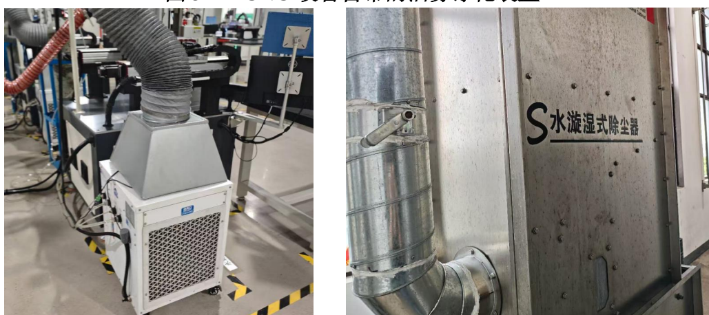
图 3-3 焊接废气配套的“焊接烟尘净化器+水漩湿式除尘器”装置
