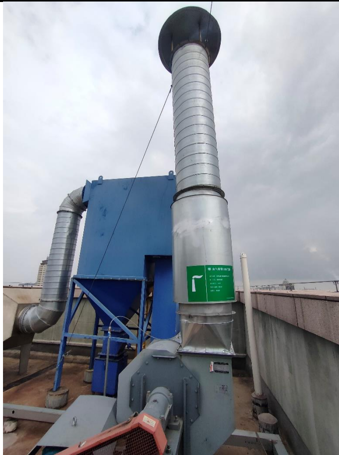
图 3.2-3 焊装废气处理装置及排气筒
