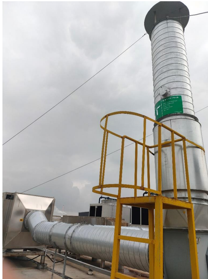
图 3.2-2 表面金属化处理装置及排气筒
