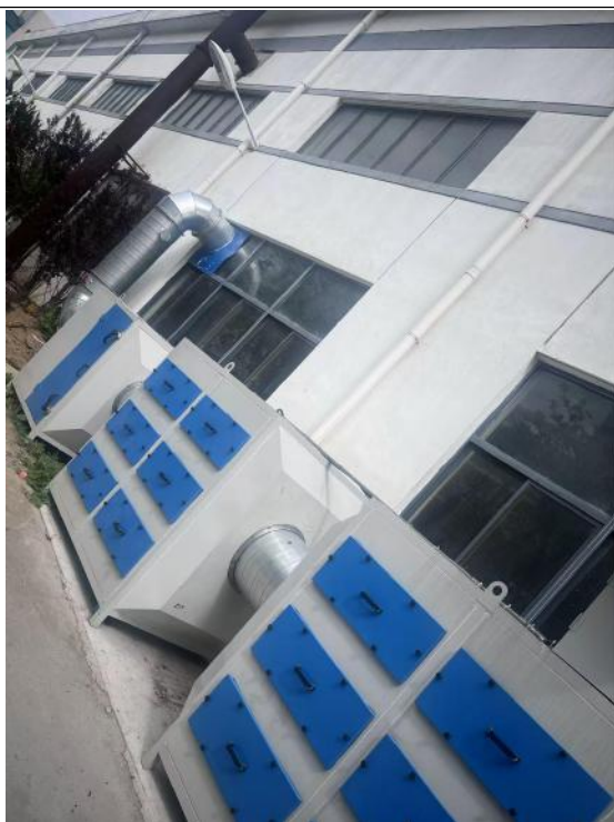
DA003 排气筒废气处理设施
