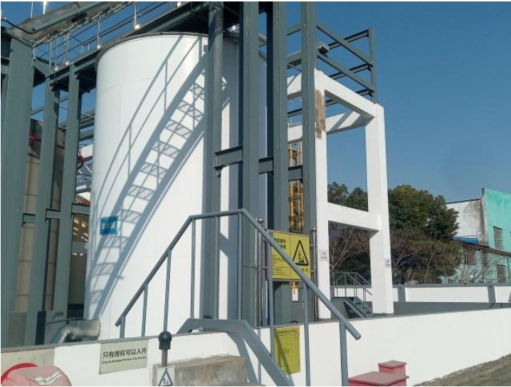
图 3.9-2 废水储罐图片
