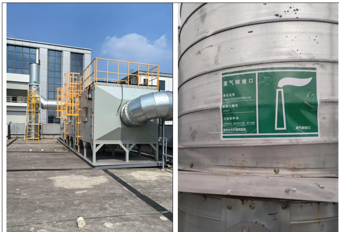
图3-2 废气处理装置及排气筒
