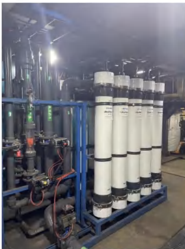
超滤设备（废水回收系统）
