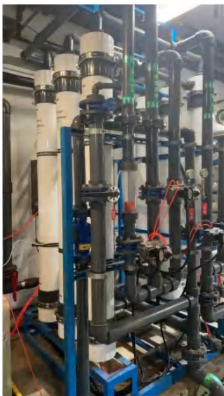
超滤设备（纯水制备）
