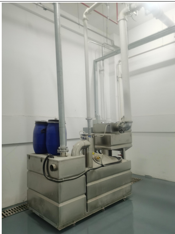
餐饮废水隔油装置
