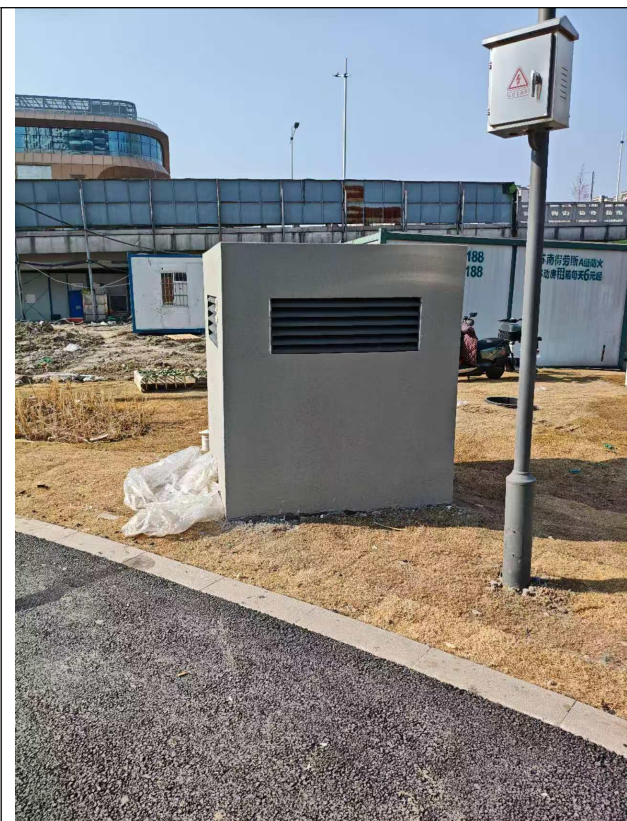
地下车库通风系统（共13个排风及进风井，距地高度1.7m~27.8m）
