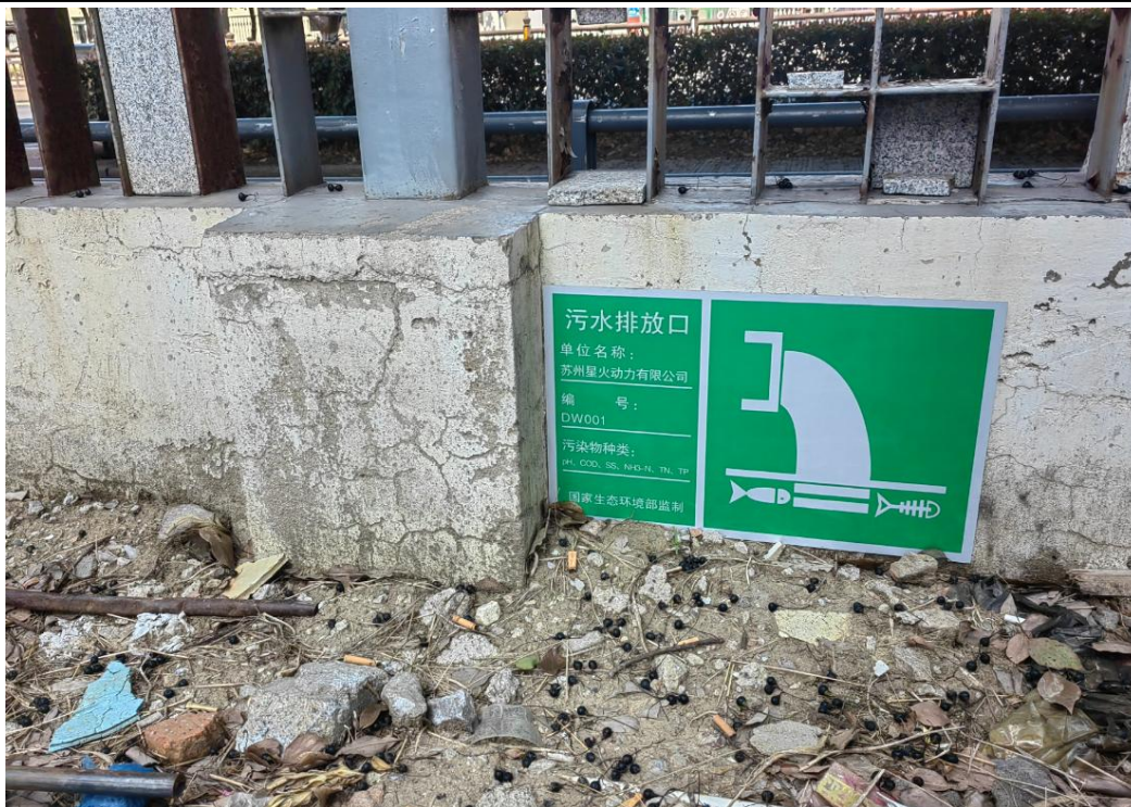
图 3-1 公司污水接入租赁厂区污水管网口（含标识）
