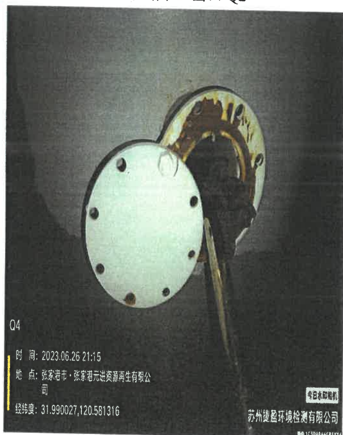
采样点位: 排气筒 4#出口 Q4
