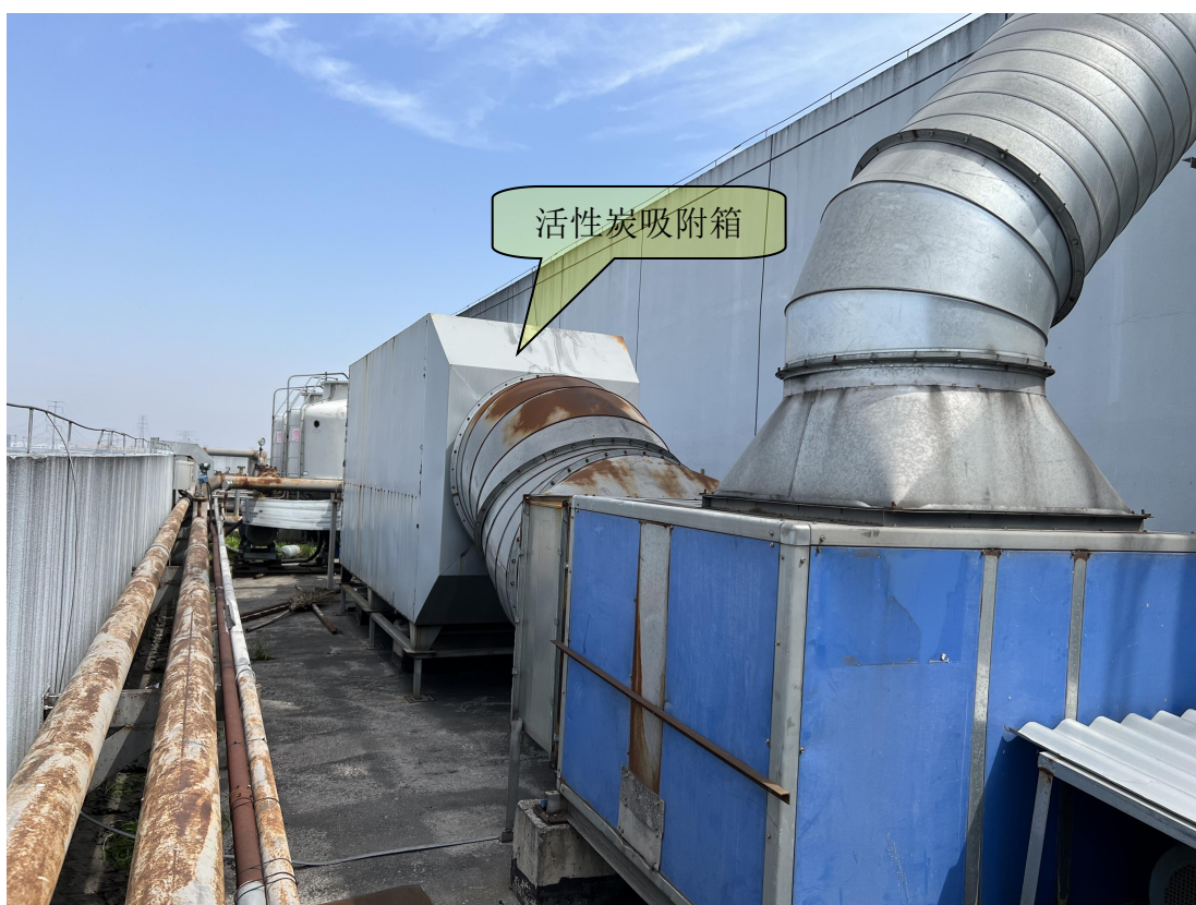
废气处理设施
